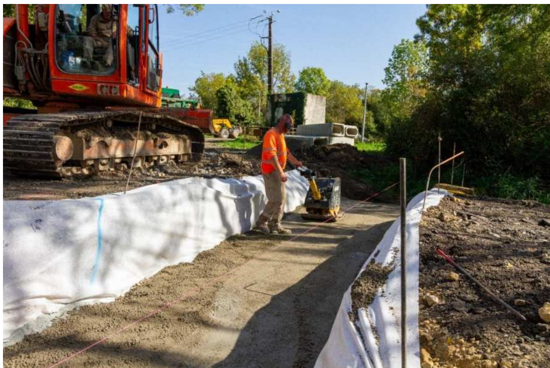
Figure 9 : tassement du lit de pierres
