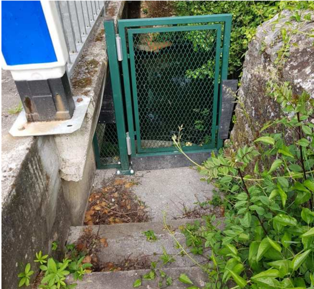
Figure 20:vue du portillon automatique de sécurisation de l'escalier piéton en aval de l'ouvrage 51
