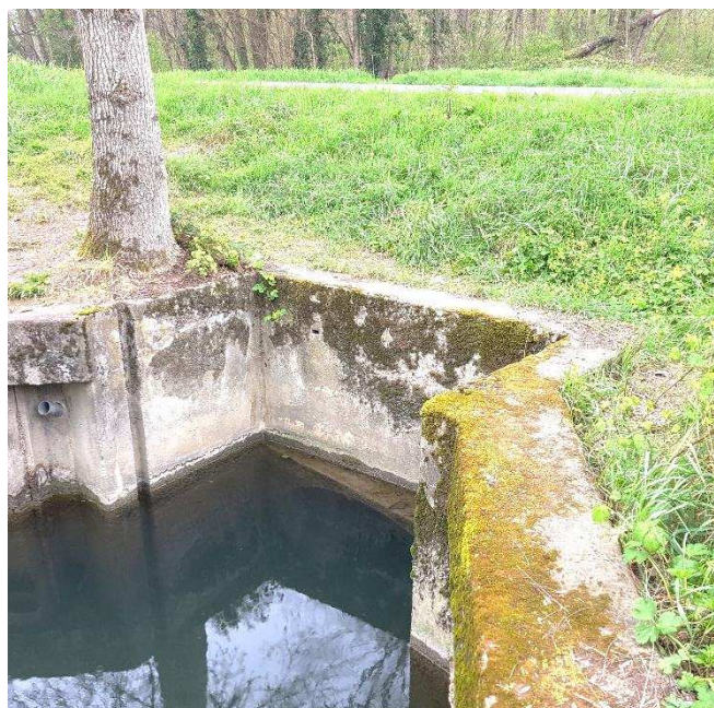
Figure 9:vue de la buse immergée du canal de ceinture
