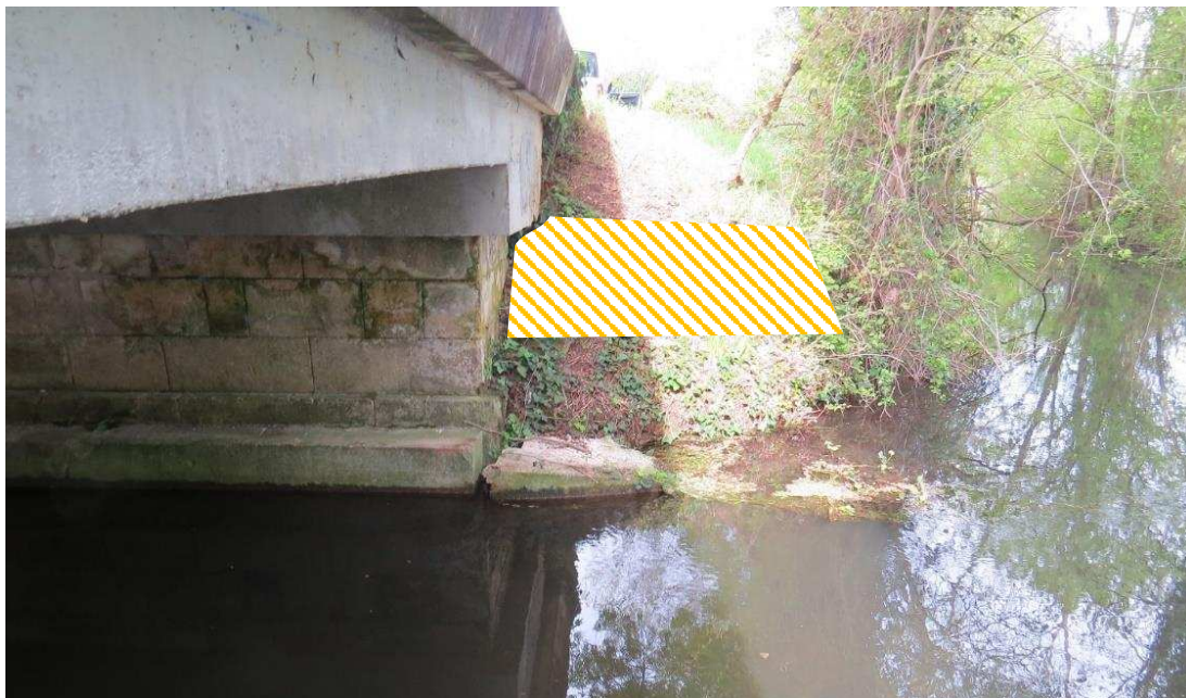
Figure 11: représentation de la zone de décaissement en aval de l'ouvrage 51 rive gauche
