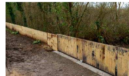
Palissade avec portail étanche pour accéder aux parcelles privées © LPO/LIFE VISON
